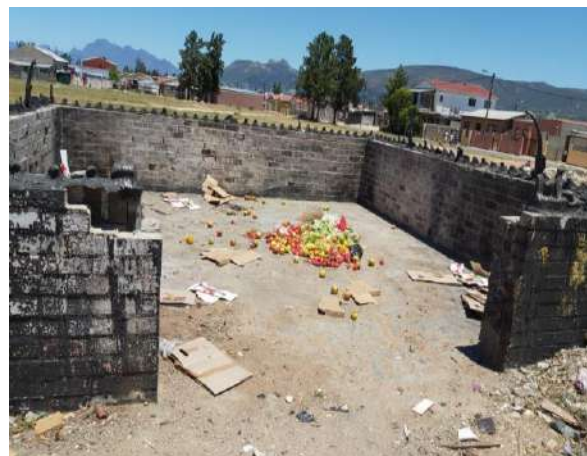
Figure 52: Vandalised mini drop-off
